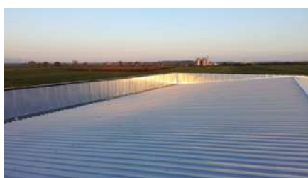
» Vista esterna copertura sistema DELTA
