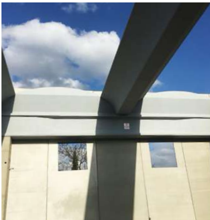
» Appoggio "PRISMA" su Trave Laterale "ADI".
